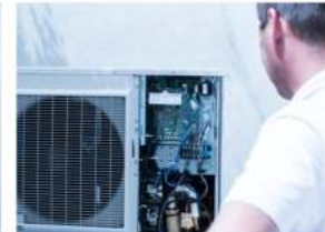
Installations de chauffage
